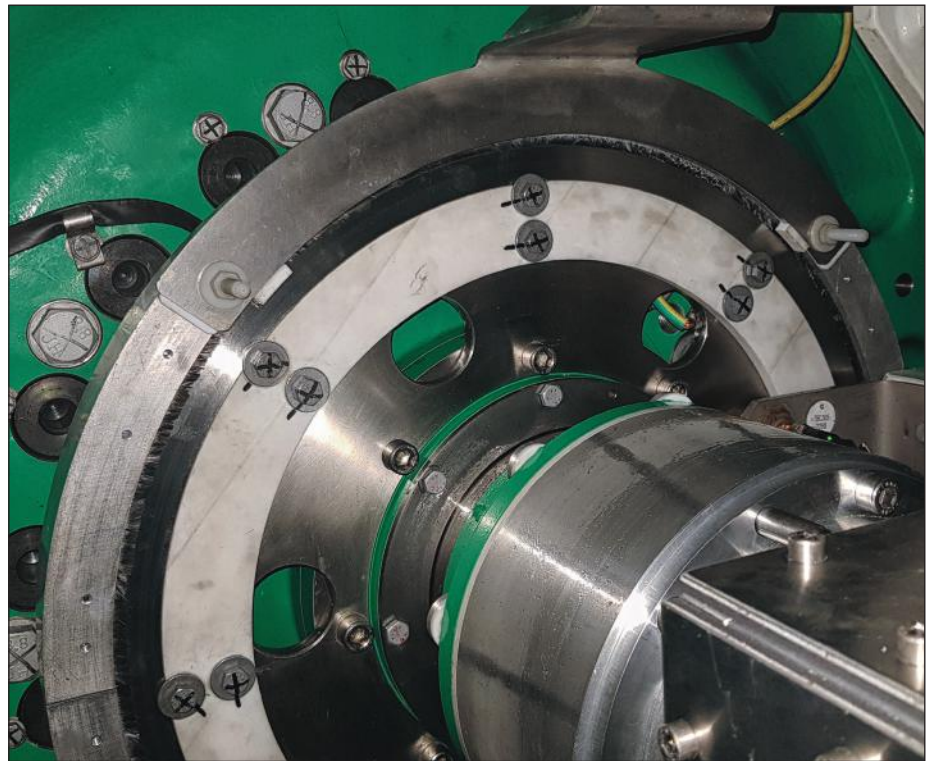
Nach Montage des AEGIS® PRO-Rings konnte die Wellenspannung auf weniger als einem Volt gesenkt werden.
